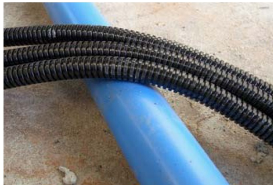
Figura 6.9 - Esempi di condizioni accettabili nell'incrocio tra tubi EEC e altre tubazioni non idriche (impianto di aspirazione polveri)
