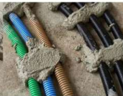
Figura 6.5c: distanziamento dei tubi per consentire l'inserimento fra di essi della colata del massetto
