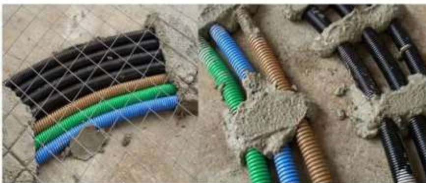
Figura 6.5b: protezione con rete elettrosaldata
